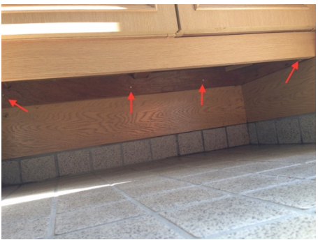
写真 5 玄関は床下から施工できないため下駄箱の下から薬剤を穿孔注入しました。
